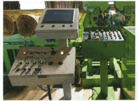
操作盤とモニターです
