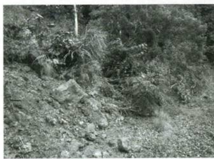
▲林道の土砂崩れ
